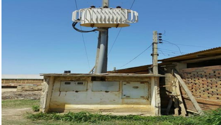
Figura 5.1 – Quadro geral de energia
