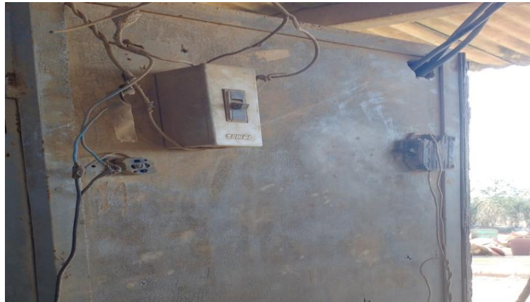
Figura 5.7 – Disjuntor exposto sem proteção.
