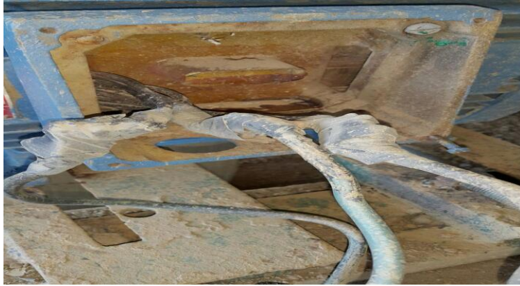
Figura 5.5 – Caixa ampliada, evidenciando os riscos.
