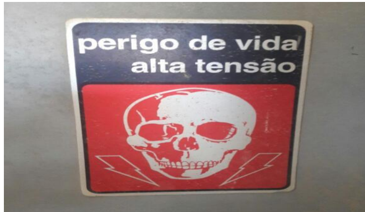
Figura 5.8 – Placa de sinalização.
