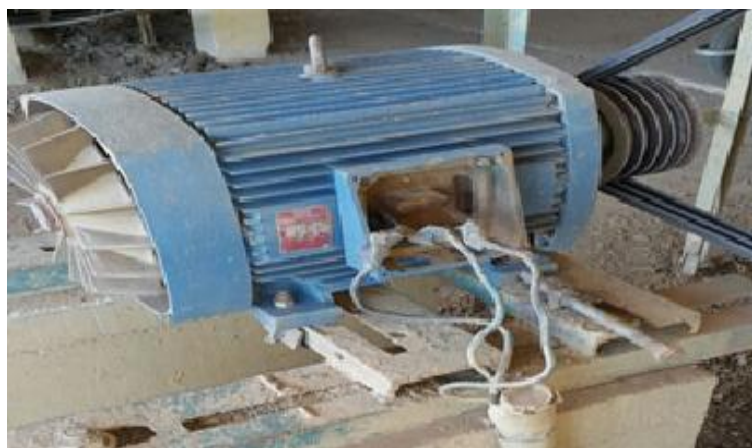
Figura 5.4. – Motor com condutores expostos
